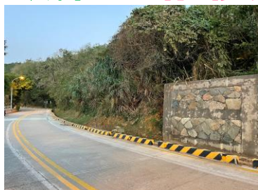
環島北路切割棲地：擋土牆設置不足，且以混凝土為主，無法提供補償生物棲地
