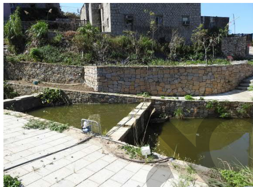
工程預定地現況-水池優氧化嚴重
