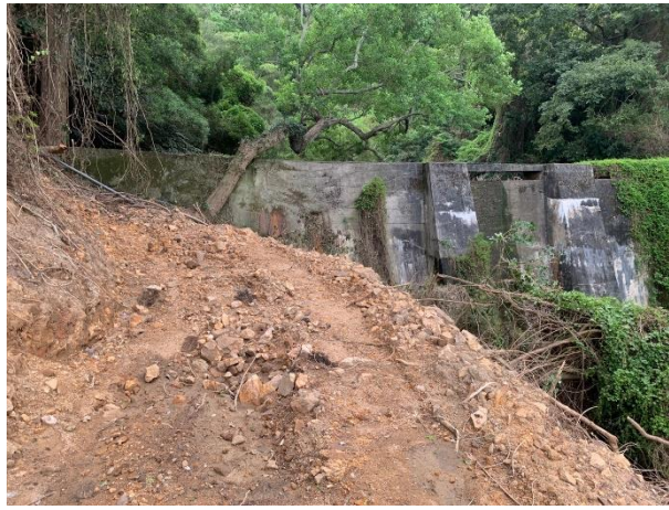
原崩塌地情形
