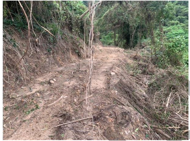
原崩塌地情形
